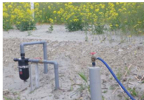
再生利用交付金で設けた畑地灌漑施設
